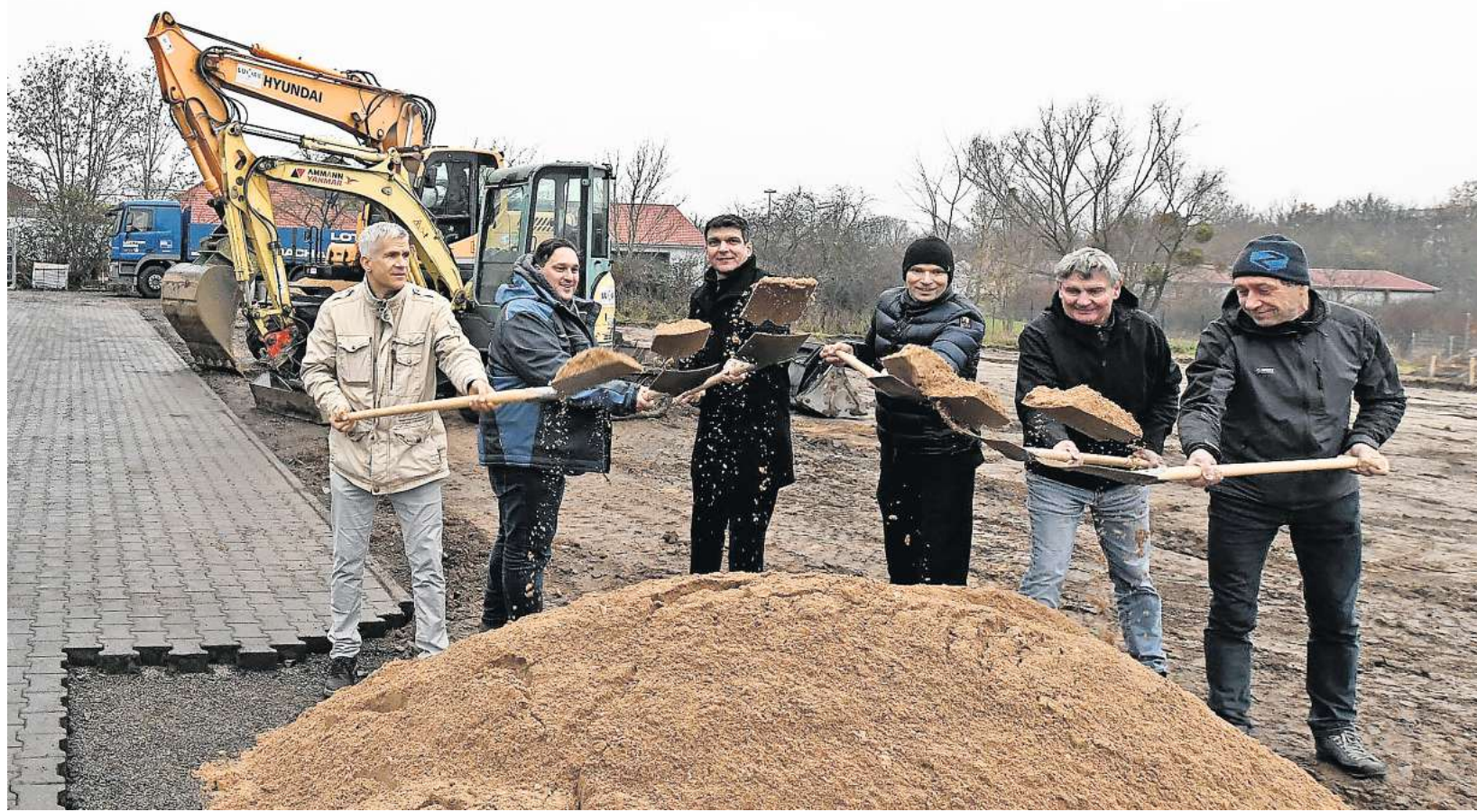
Die Lotter Metall GmbH & Co. KG baut an ihrem Standort in Grimma am Gerichtsweg eine neue Lagerhalle. Zum symbolischen Spatenstich kamen auch Landrat Henry Graichen (CDU, 3.v.l.) und Grimmas Oberbürgermeister Matthias Berger (parteilos, li.) auf das Firmengelände. FOTO: THOMAS KUBE
